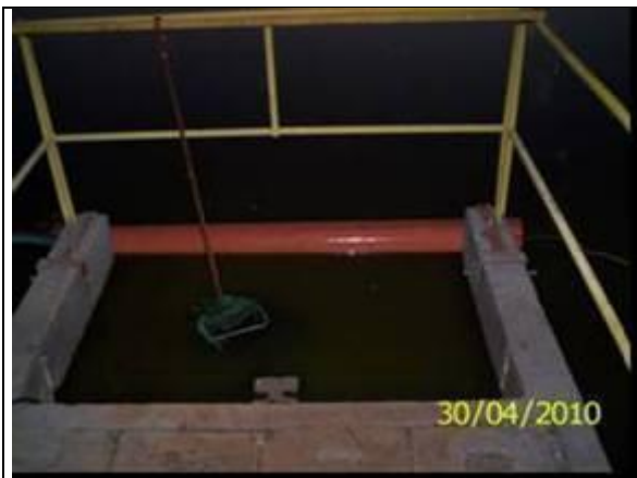
Figura 6 – Tubo para retenção de sobrenadante no vertedouro da lagoa facultativa.
