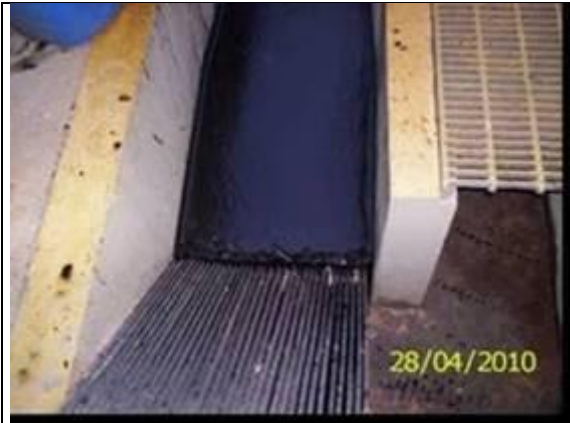
Figura 2 – Óleo retido no gradeamento da ETE
