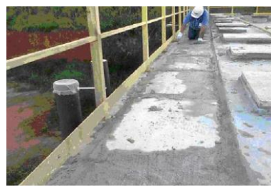
Figura 15: Vedação das tampas do canal de efluente do UASB
