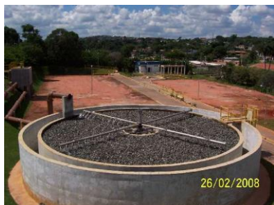
Figura 4: Filtro Biológico Percolador
