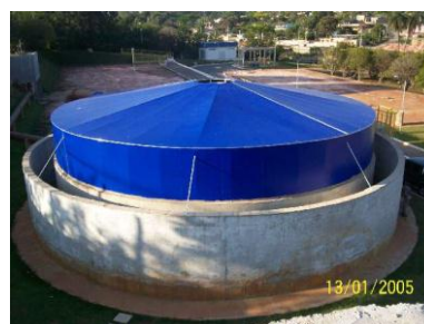
Figura 18: Cobertura do filtro biológico
