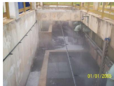
Figura 6: Elevatória de recirculação efluente
