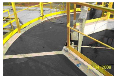
Figura 12: Cobertura das caixas de chegada de esgoto bruto que precede os reatores
