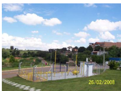
Figura 7: Sistema de queima de gás
