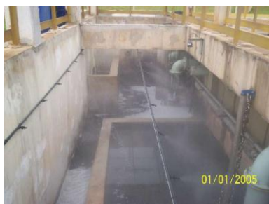
Figura 10: Dosagem de produto na elevatória de recirculação
